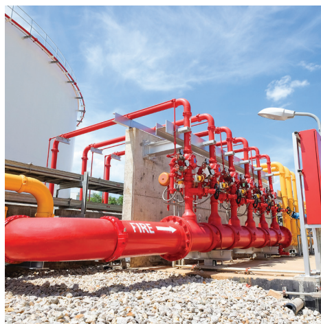
HỆ THỐNG PCCC FIRE ALARM SYSTEM
